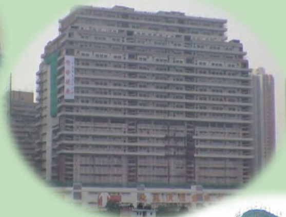
緊急屋宇結構鞏固
